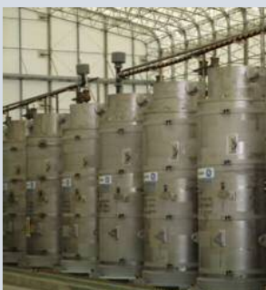
多核種除去設備(ALPS)
